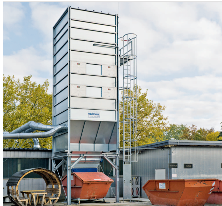
Zu der Höcker-Technik, die in Melle genutzt wird, gehört auch diese Filteranlage „Multi Star VQ-6-6“, die hier auf dem dem Innenhof der FH Melle zu sehen ist. Fotos: Höcker Polytechnik
