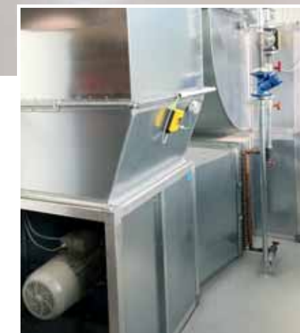
Links: Innenansicht des Lackierbereichs mit stirnseitiger Absaugwand. Rechts: Die Wärmeenergie bleibt dank des Rotationswärmetauschers weitgehend erhalten
