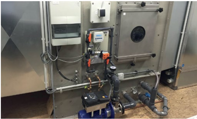
Befeuchtungsanlage für die Zuluft.
