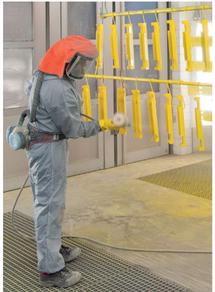
Optimale Arbeitsbedingungen für die Mitarbeiter im Lackierbetrieb.
