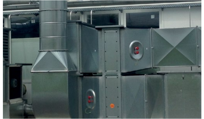
Kombiniertes Zu- und Abluftgerät mit Rotationswärmerad.
