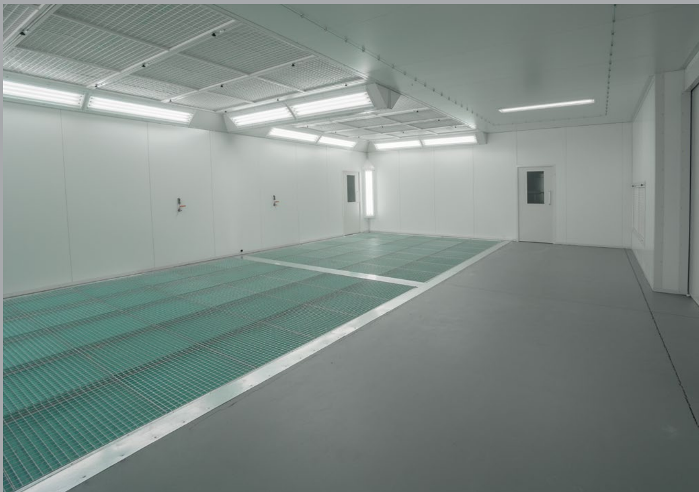
Großraumlackierkabine mit Unterflurabsaugung und intelligenter Beleuchtungstechnik.
