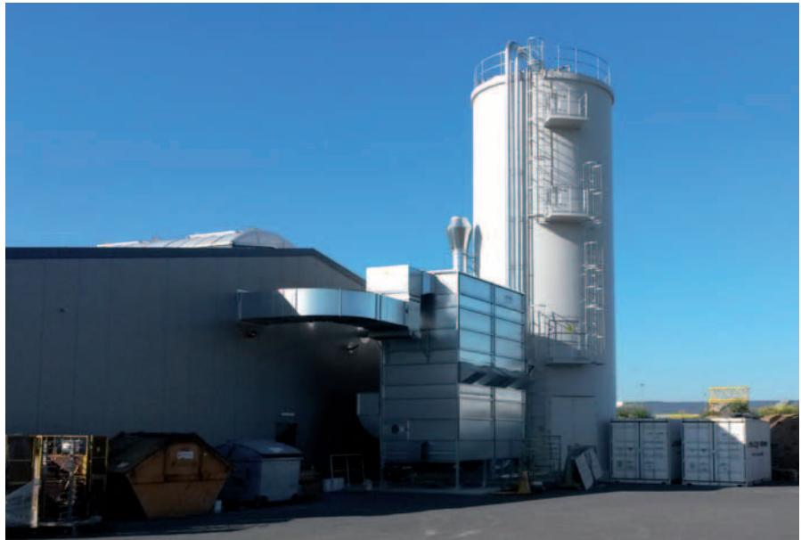
Höckers MultiStar Filteranlage ist das Herzstück der Staub- und Späneabsaugung.
