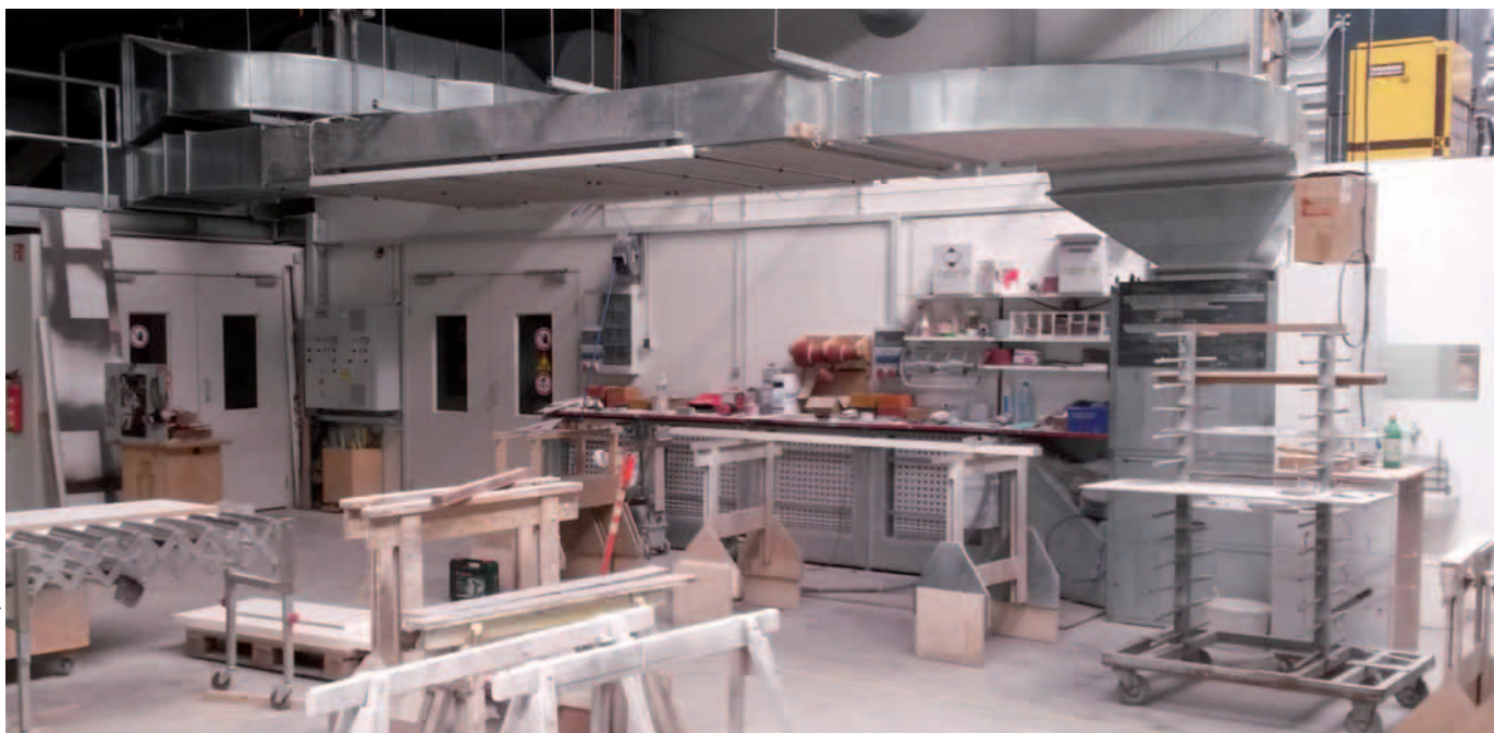
Die Lackierkabine wurde platzsparend in den Werkstattbereich integriert.
